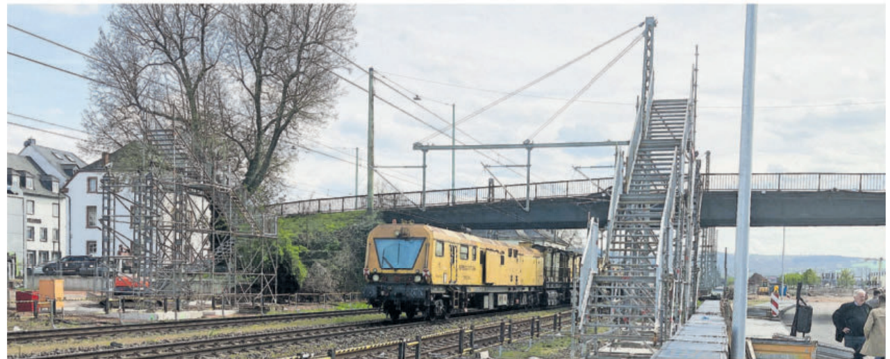
Zwischen dem Römerbrückenkreis und der Hornstraße wird für mehr als zehn Millionen Euro eine neue Brücke gebaut. Die Ersatzbrücke für Fußgänger steht bereits teilweise. Sobald diese provisorische Verbindung fertiggestellt ist, kann die baufällige Brücke gesperrt werden.
