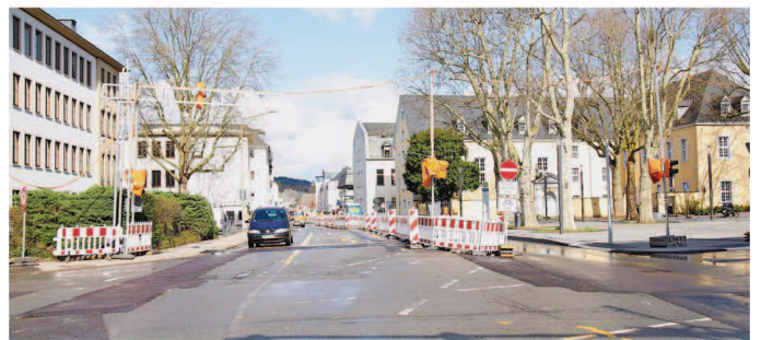
Wegen der Bauarbeiten ist die Justizstraße ab kommender Woche für den Verkehr aus Richtung Pferdemarkt gesperrt. FOTO: ROLAND MORGEN
